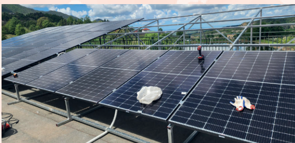
Duurzame hulp in de vorm van zonnepanelen op het dak van het kinderkuis.
